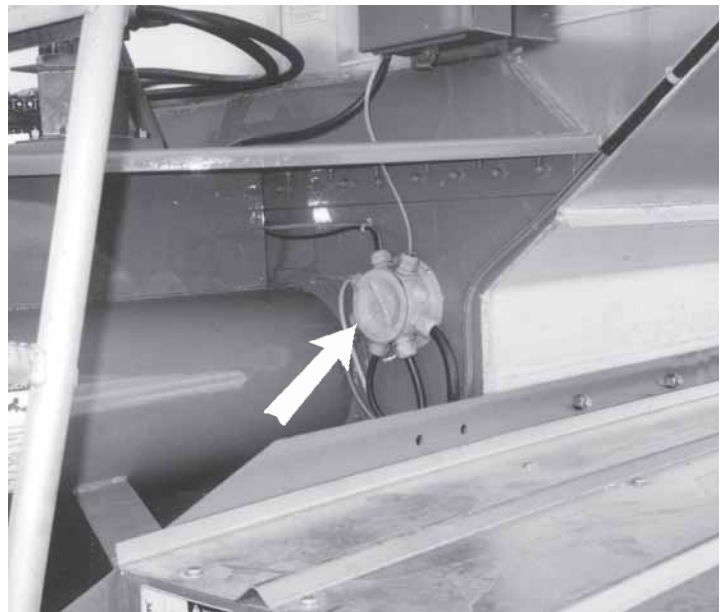
Boîte de jonction électrique
